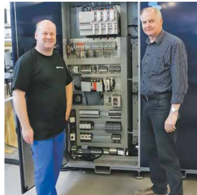
Industrielektriker Bent Kristensen, t.v., og Logistik- og produktionschef Bent Skovshoved, t.h., begge Roll-o-Matic A/S, har åbnet styreskabet på en af maskinerne.
